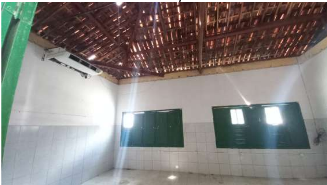
Figura 52. CONSTRUÇÃO DE SALAS DE AULAS NA ESCOLA MUNICIPAL PROFESSORA IVONE GONÇALVES DE ARAÚJO
