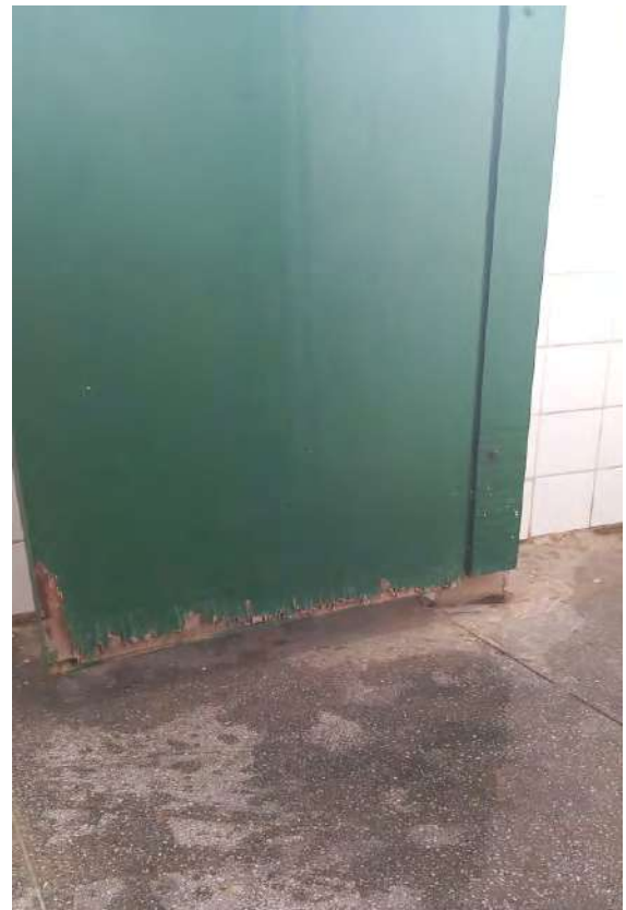
PORTAS PRECISANDO DE REPAROS
