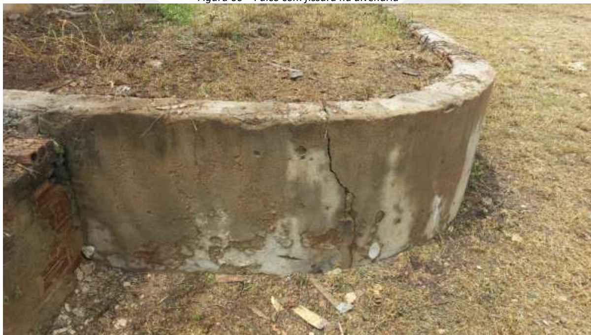
Figura 66 – Palco com fissura na alvenaria
