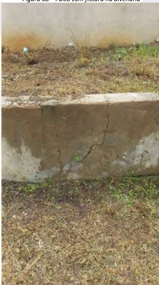
Figura 68 – Palco com fissura na alvenaria
