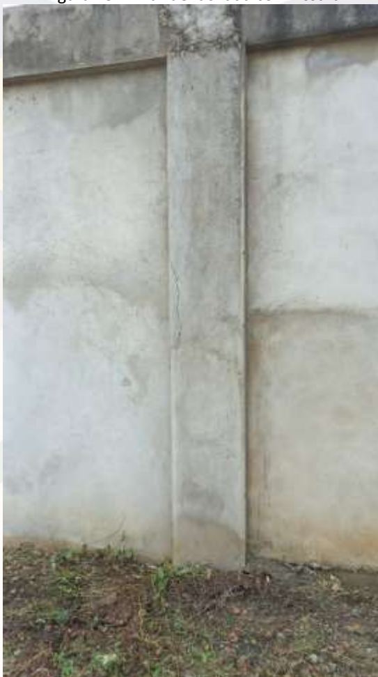
Figura 15 – Pilar de fachada com fissura
